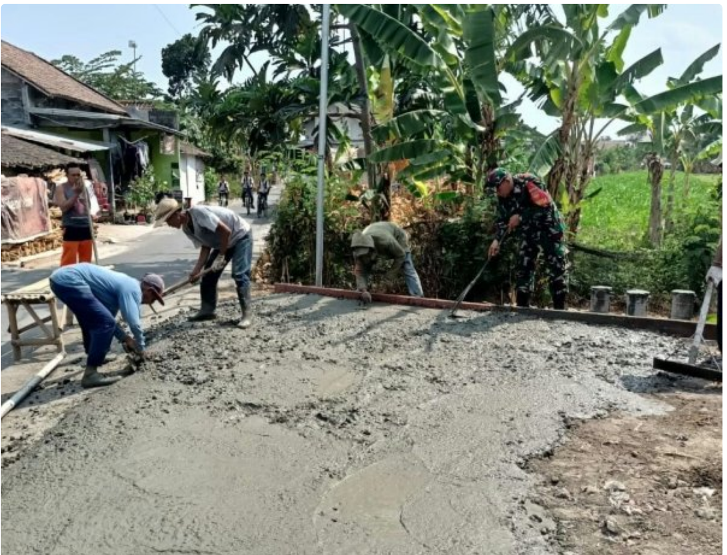
Kemanunggalan TNI Bersama Rakyat, Babinsa Koramil Klaten Utara Gotong Royong Pengecoran Jalan
