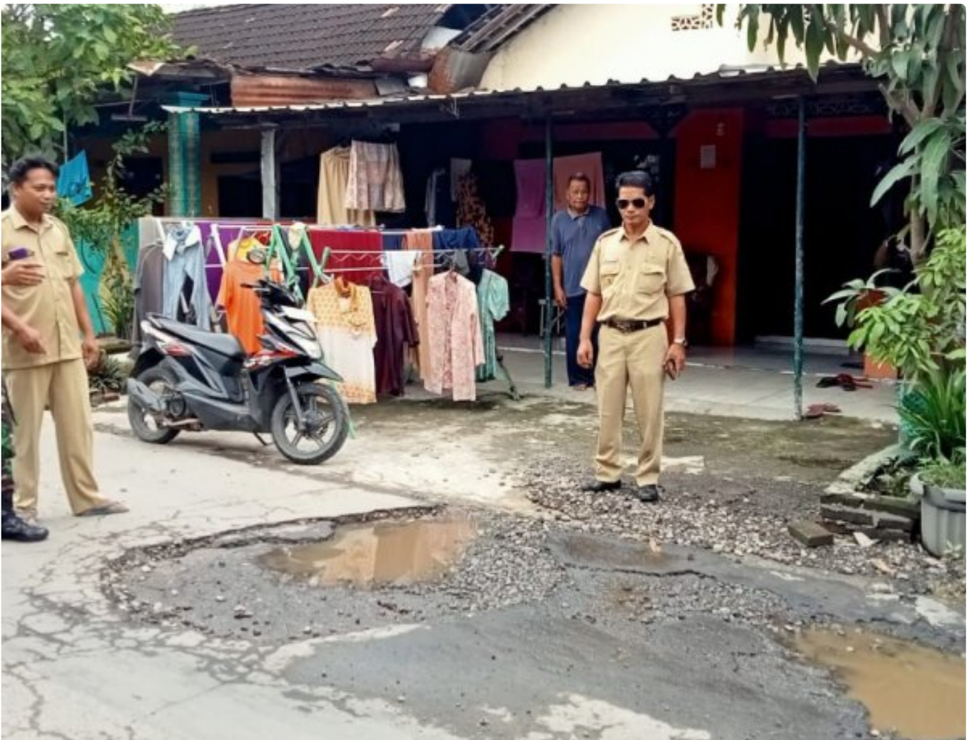
Jalan Rusak, Babinsa Wonosari Cek Kondisi Jalan Bersama Pemdes
